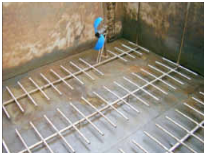
Der alte Belüfter.
