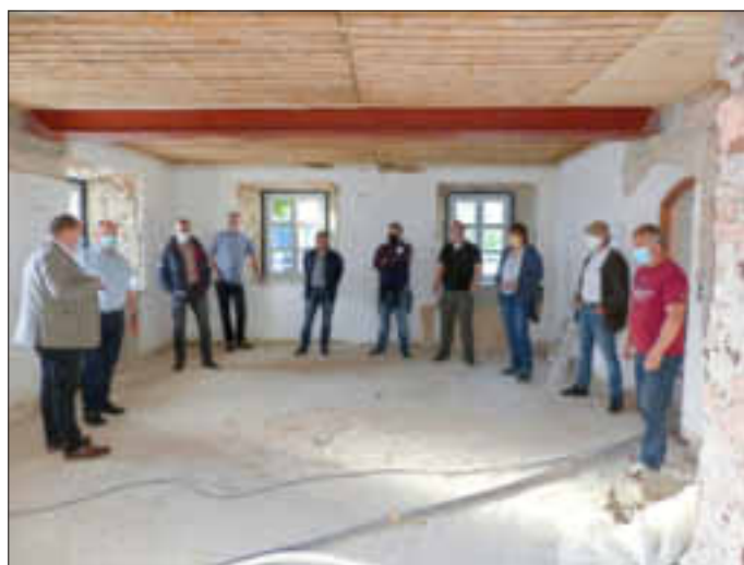
Bürgermeister Werner Burger (von links) und VG-Geschäftsstellenleiter Michael Laaber (daneben) erläuterten dem Marktgemeinderat den aktuellen Stand der Bauarbeiten.
